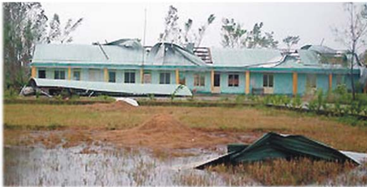
TRỤ SỞ CÔNG AN HUYỆN ĐIỆN BÀN- QUẢNG NAM (BẢO XANGSANE) Ảnh. DOÃN KHUẾ
